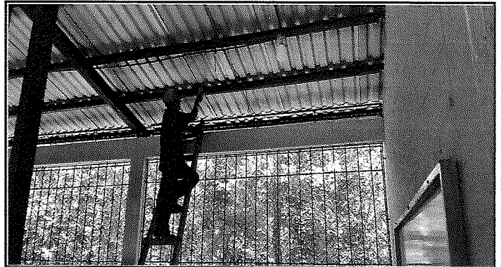
LIJADO DE LA ESTRUCTURA METÁLICA, EN UNO DE LOS SALONES DE NUESTRA ESCUELA.
